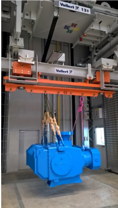
图 1 沃乐特为 LEWA 研发了一个非常紧凑的涂层系统，可承载高达 12 吨的载荷。在只有 15 x 25 米的区域内，拥有装卸机械手、洗涤和涂装间、烘干机和后处理空间。
