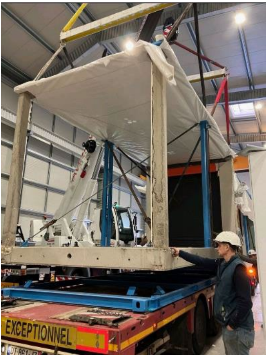
图 12 : 经过重量优化的生产工艺使得每辆卡车可以一次将两个空间模块运送到施工现场。
